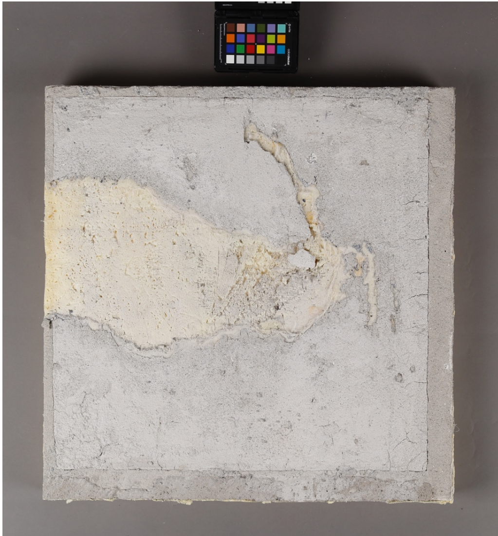
Abb. 5 Recto Ansicht des Bildfeldes P. Die Sicht fällt durch die Abnahme auf die Rückseite/den Putz der Maloberfläche. Die Malschicht liegt noch auf dem Facing (gelb).
